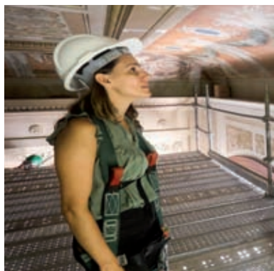
O desafio foi levar infraestrutura moderna sem modificar o aspecto histórico do Palácio
